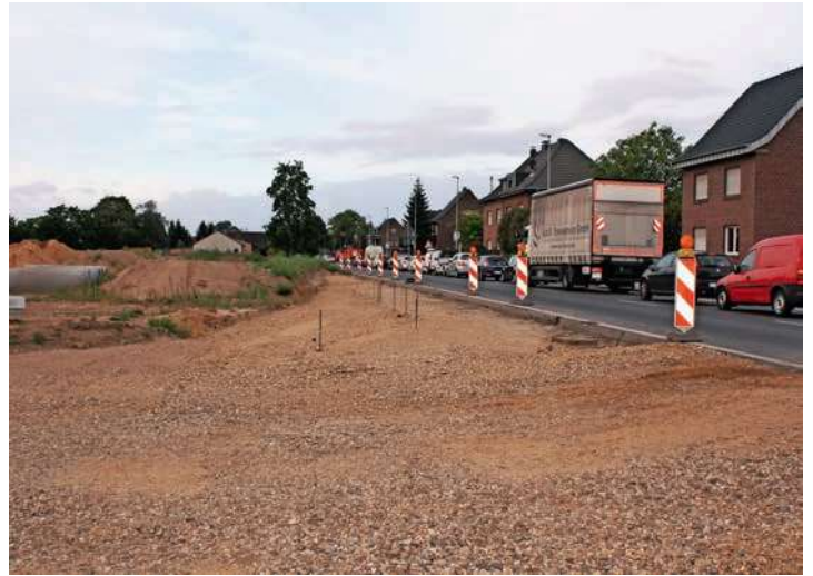
Die neue Zufahrt für die Sportanlage erfolgt über die B221, hier werden derzeit auch die Parkplätze gebaut und die Erschließungsmaßnahmen für das Baugebiet ausgeführt. Foto: Küppers
